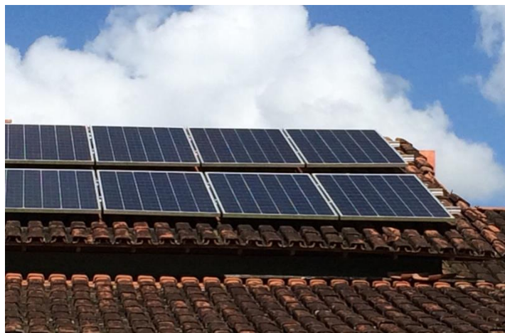
Fotografia 1 : Pannel Solar Fotovoltaico - Fonte: Dados da Pesquisa
