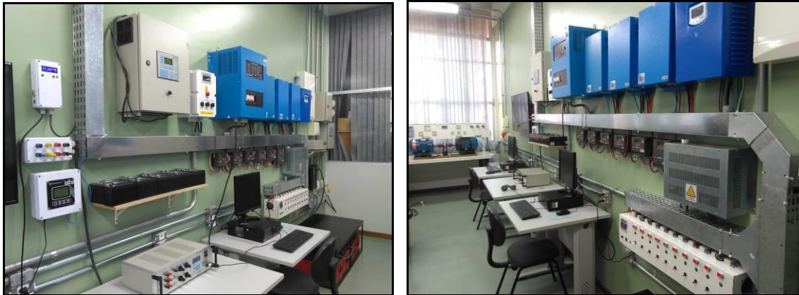
(a) (b) Figura 26 – Vista geral da Sala de Controle do Sistema Híbrido – (a) Lado Esquerdo – (b) Lado Direito
