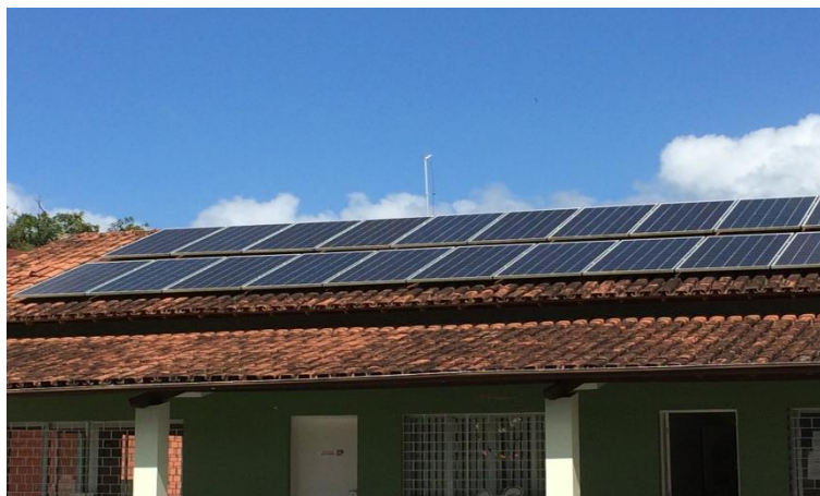
Fotografia 2 : Paineis Solar Fotovoltaico - Fonte: Dados da Pesquisa
